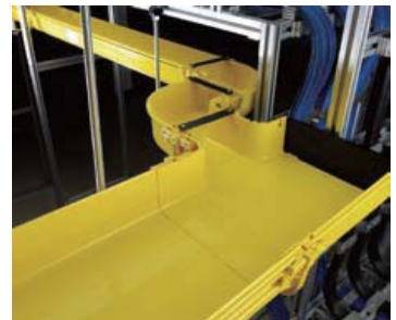
光纤槽道水平弯头及出口
