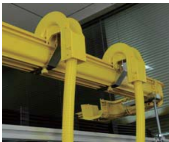
光纤槽道下引
