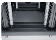
网络机柜内垂直理线槽
