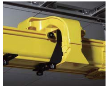
光纖槽道下出纖方式
