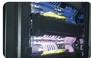
垂直、水平理線槽搭配使用
