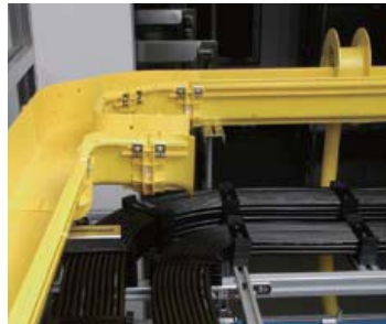
光纖槽道水平三通出口
