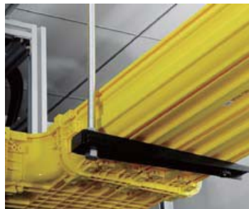
光纖槽道托臂
